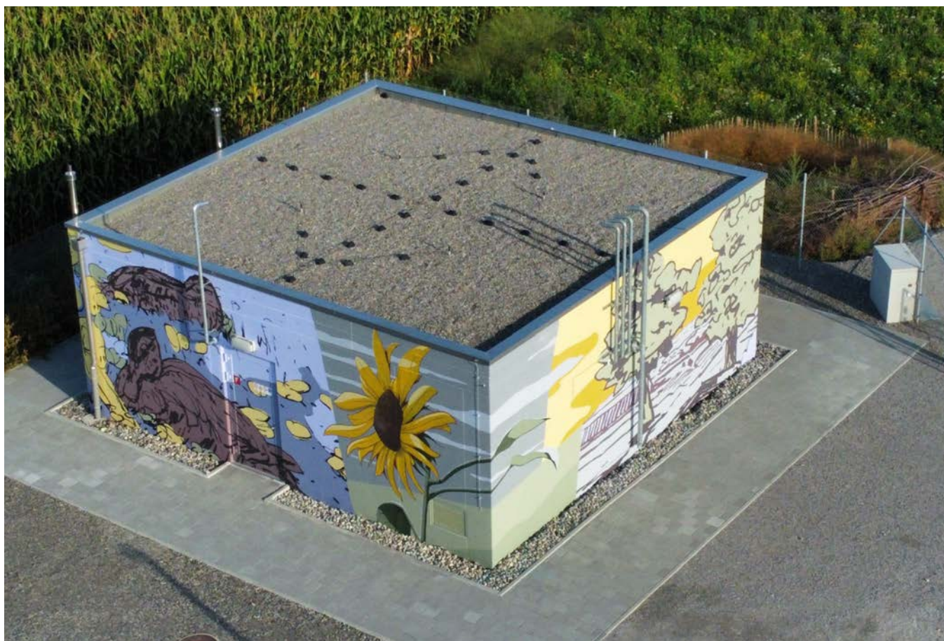
Druckreduzier- und Messstation (DRM) Moosseedorf
